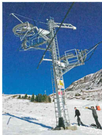
Télésiège du Col. Pylône d'angle.
